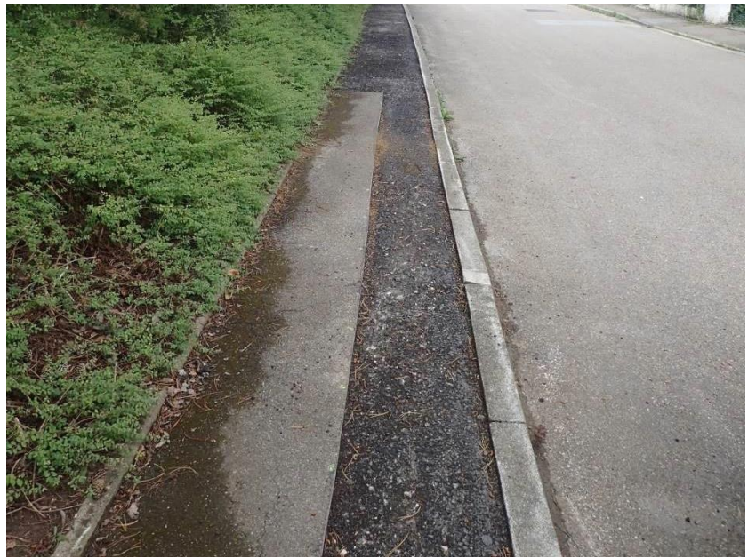
Abbildung 42: Beispiel Zustand Gehwege Wohnstraßen
